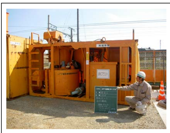
緩み土圧抑制材 注入プラント (プランジャーポンプ)
